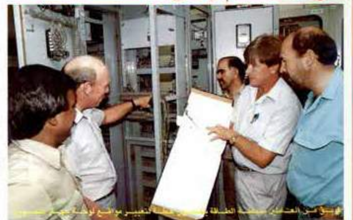
تجرى حالياً تطويرات رئيسية في غرفة الإعداد الكهربائي لخطوط المصهر الثلاثة المراقبة التابعة لمحطة الطاقة، تستهدف دمج تمهيداً لتشغيل خلايا التوسعة الجديدة.
