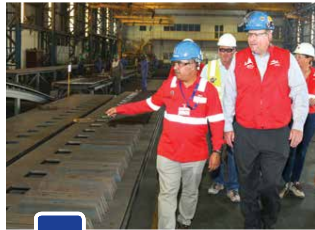
08 Alba Line 6 Pot Shell Fabrication in Full Swing تصنيع هيكل الخلايا لخط الصهر السادس في البيا سيرير بكامل طاقته
